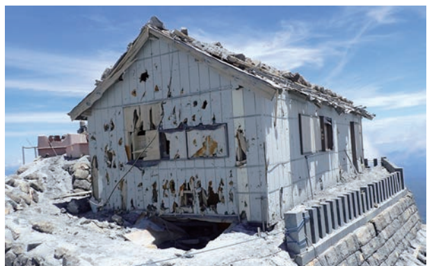
【写真3】御嶽山山頂近くの山小屋。山小屋の火口をむいた壁はたくさんの噴石で穴だらけになっています。噴石の勢がよくわかります。噴火予知連総合観測班提供。
